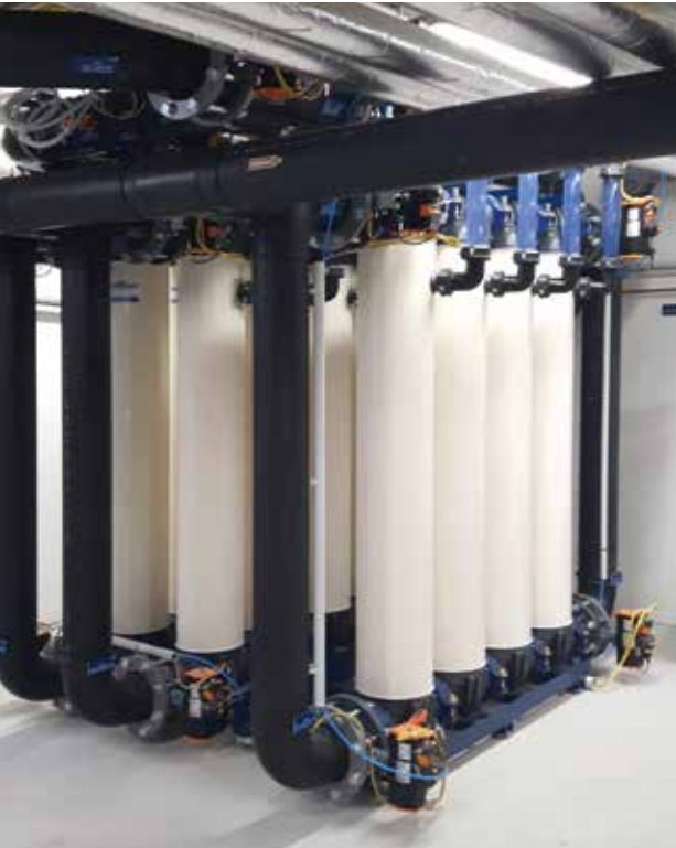
▲ Ultrafiltrationsmodule im Untergeschoss zur Badewasseraufbereitung
